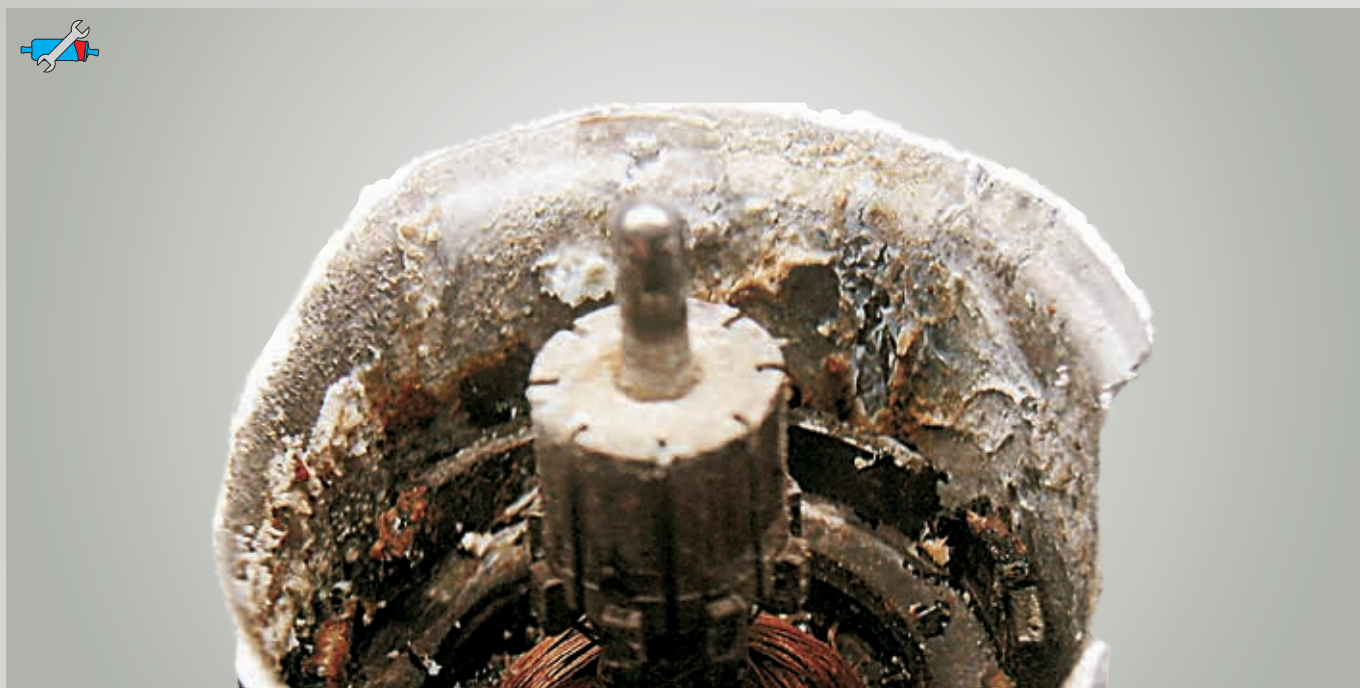
Рис. 16: Сильно корродированный электрический топливный насос Как правило, в мастерской не сталкиваются с такой картиной. Во многих случаях только открытие топливного насоса позволяет определить, почему внешне исправный насос вышел из строя.
